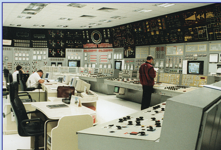
Bloková dozorná JE V-1 po rekonštrukcii Control room in NPP V-1 after the reconstruction
