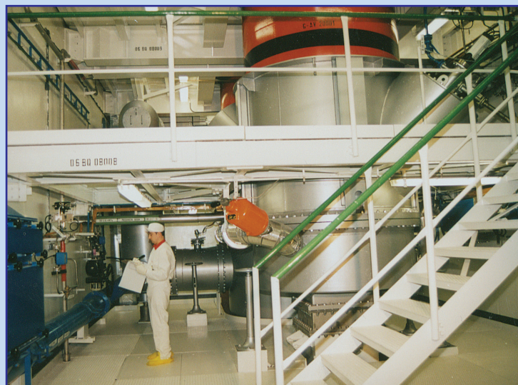
Bohunické spracovateľské centrum (BSC RAO) Bohunice Radioactive waste Treatment (BSC RAW)
