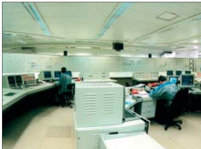
Bloková dozornia JE Mochovce NPP Mochovce Unit Control Room
