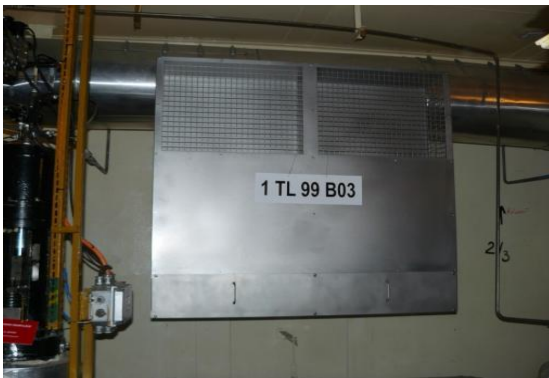
Obr. Inštalácia pasívnych autokatalytických rekombinátorov vodíka
