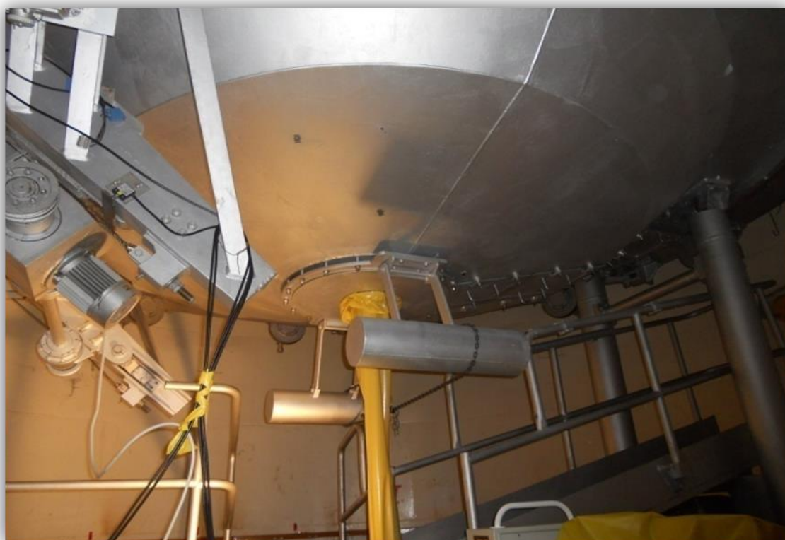
Obr. Spodná časť tienenia reaktora s plavákmi na mimozónové chladenie TNR
