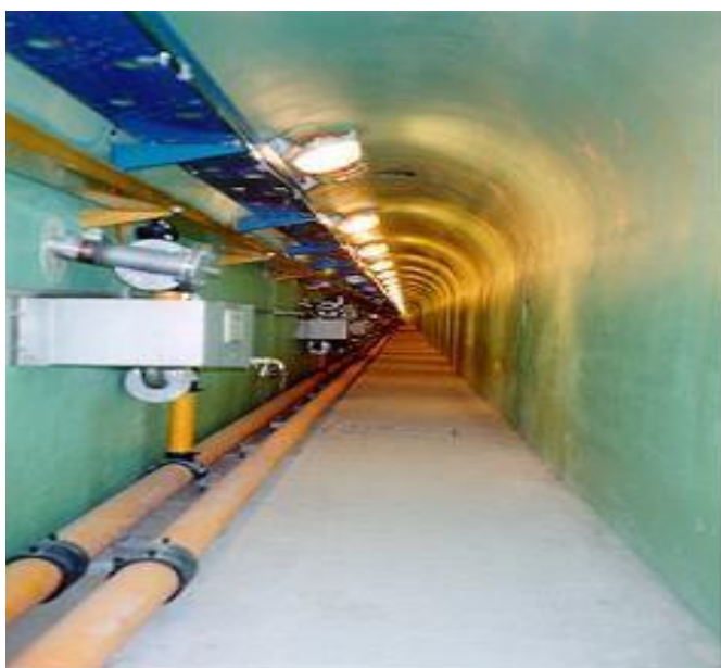
Obr. č. 24 Monitorovacie zariadenia na RÚ RAO
