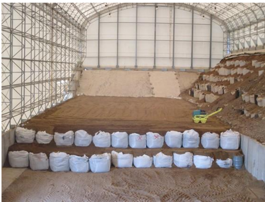
Obr. č. 10 Ukladanie VNAO v rámci 1. etapy úložiska VNAO
