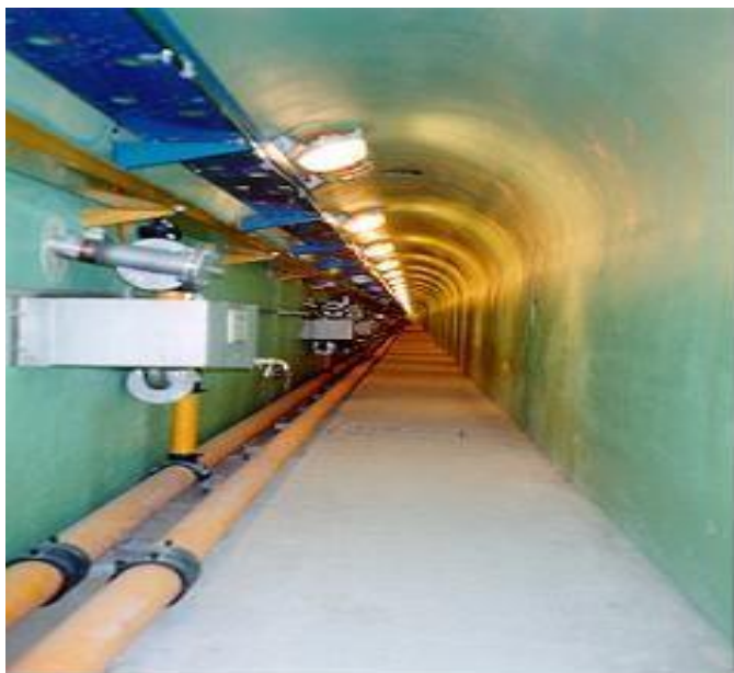
Obr. F.4.5 Monitorovacie zariadenia na Republikovom úložisku RAO
