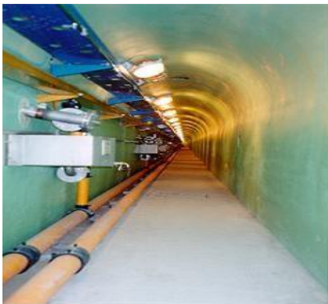
Obr. Monitorovacie zariadenia na Republikovom úložisku RAO
